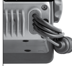
Cableado ubicado en la parte posterior del radio
